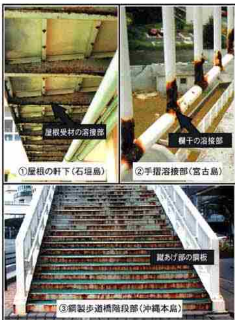
図1 沖縄県内における溶接構造物の腐食状況
