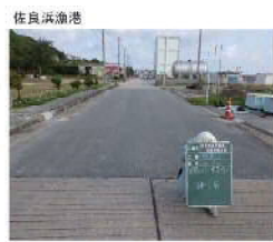
傷んだ舗装（臨港道路）
