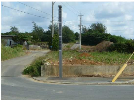
防災施設整備ソーラー照明(西東)
