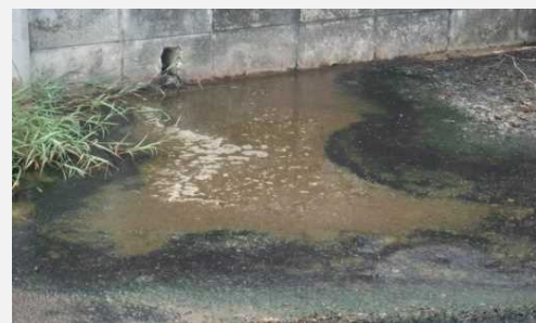
堆肥舎壁の破損による汚水の流出
