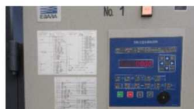
環境制御盤の導入
