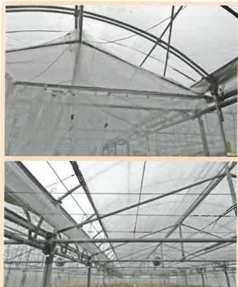
屋根面の内張りビニールで更に保温効果UP↑↑
