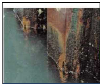
腐食が進行した矢板岸壁
