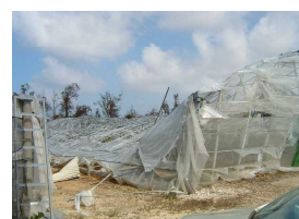
園芸施設の被害
