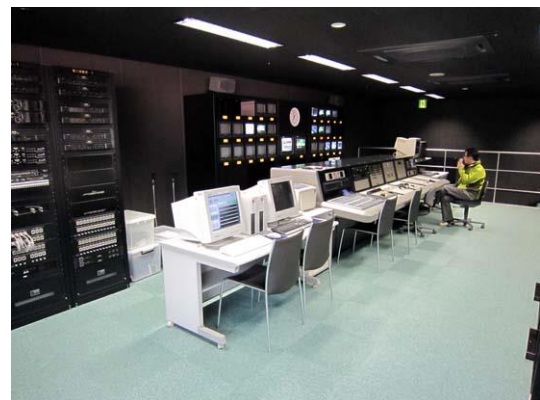
大型映像装置操作室
