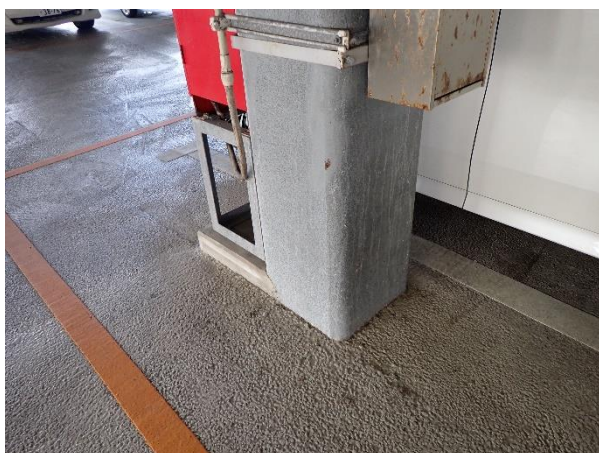
那覇空港：空港駐車場で確認した場所
