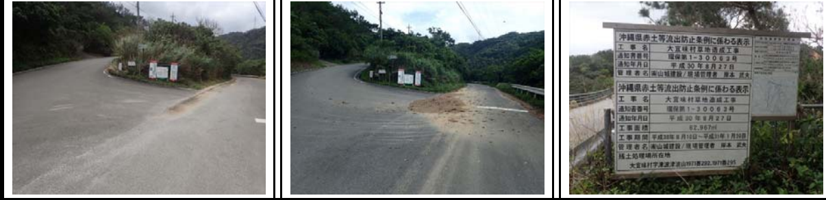
⑪ 道路上に若干堆積した赤土等の状況
