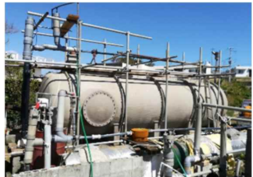
図2 10m 3 メタン発酵槽
