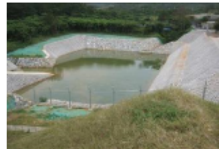
沈砂池 (排水を一時貯留して 赤土を沈殿させる施設)
