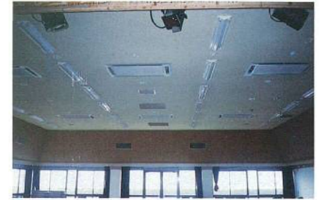
4階大会議室室内機
