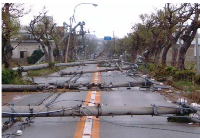
平良城辺線（宮古島市城辺）平成14年台風13号で倒壊した電柱
