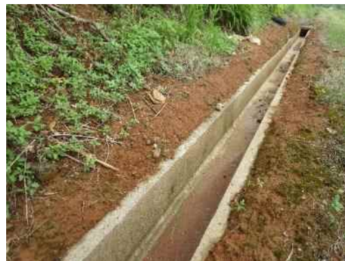
地点⑩ 赤土が流出した側溝
