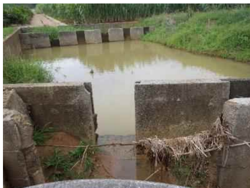
地点⑤ 集水枡の状況
