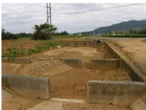
地点⑤ 集水枡の状況
