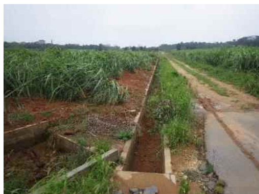
地点⑨ 赤土が流出した側溝
