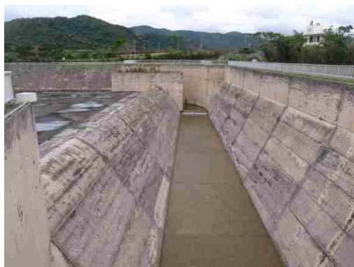
地点⑤ 真栄里ダム(放水なし)
