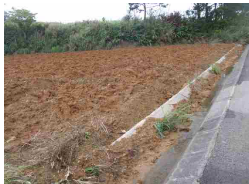
地点⑬ 道路への流出痕
