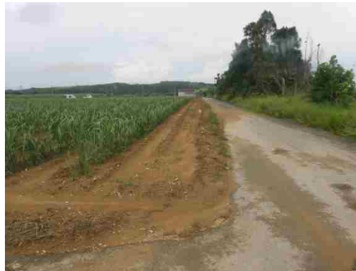
地点⑮ 畑からの土砂が道路に流出
