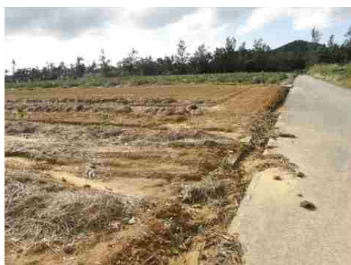
地点⑩ 水路への流出痕
