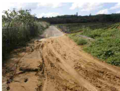
地点⑨ 道路への流出痕
