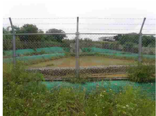
地点⑰ 沈砂池
