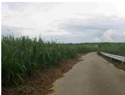
地点⑬ 畑からの土砂が道路に流出
