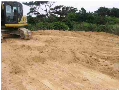
地点⑬ 新規確認造成裸地
