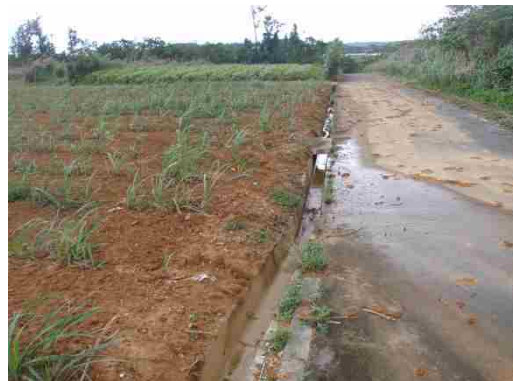
地点⑪ 道路への流出痕
