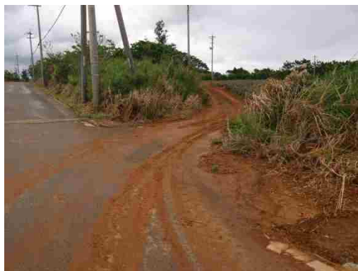
地点⑭ 道路への流出痕
