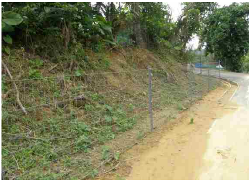
地点⑪ 流出可能性有(前回地点⑲)
