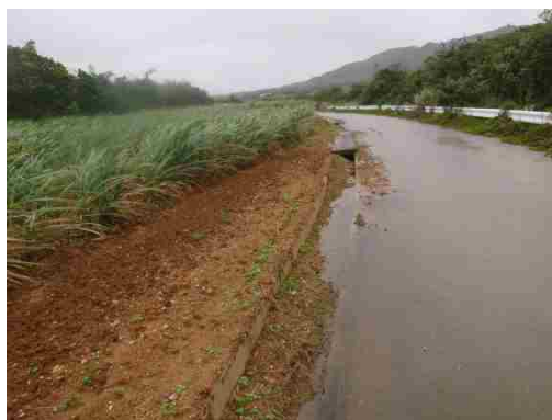
地点⑪ 流出源となりうる箇所
