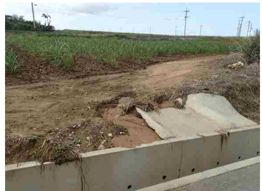
地点⑪ 水路への流出痕
