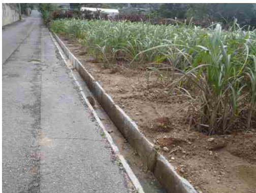
地点⑨ 流出痕箇所
