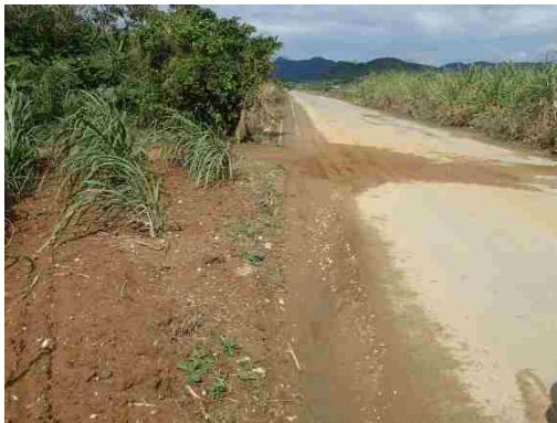
地点⑧ 道路への流出痕
