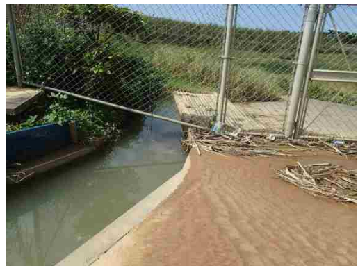
地点⑭ 沈砂池からの濁水
