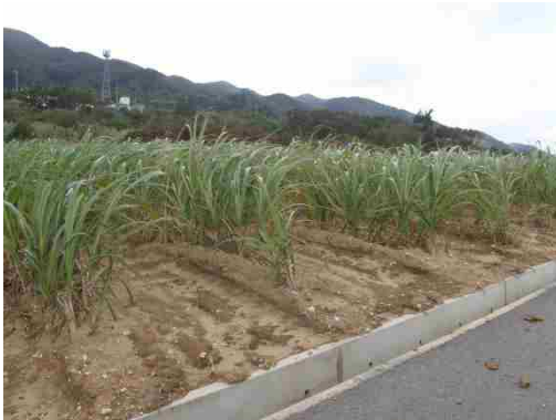
地点⑧ 流出可能性がある箇所
