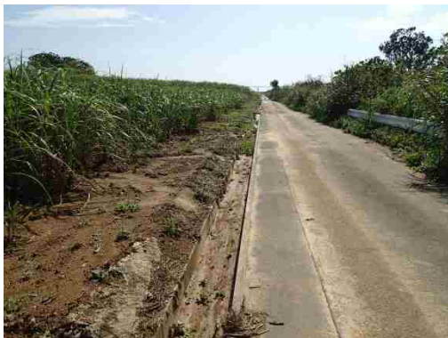
地点⑩ 水路への流出痕
