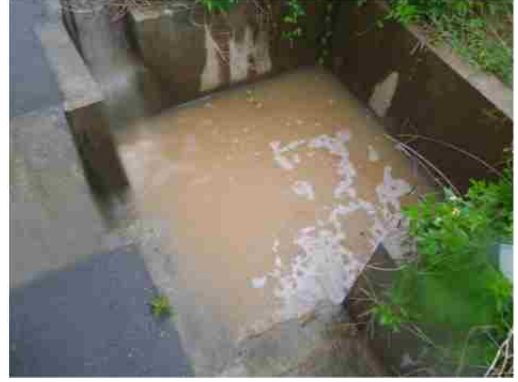
地点⑧ 集水桝(濁り有り)
