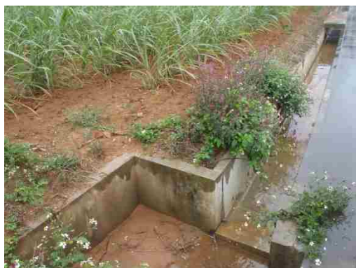
地点③ 土砂が水路に流出
