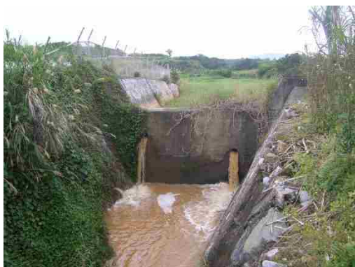
地点④ 沈砂池からの濁水流出
