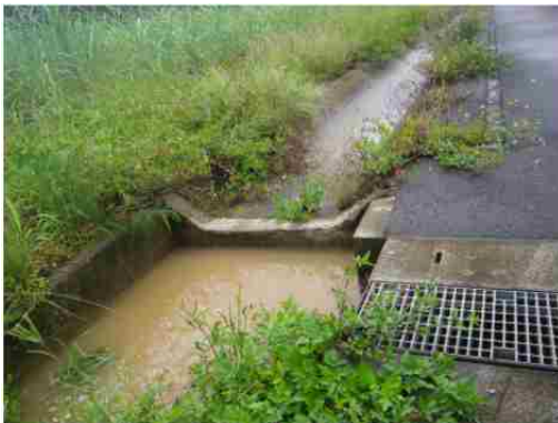
地点⑧ 集水桝(濁り有り)
