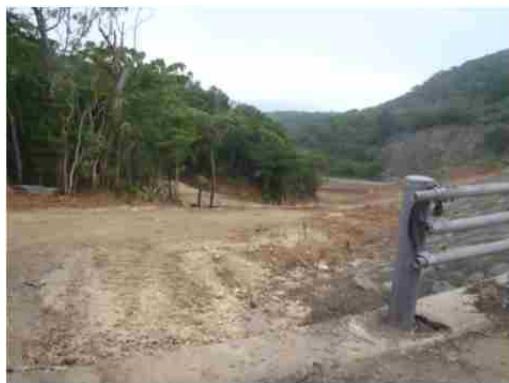
地点⑦ ダム堤体横工事による斜面裸地
