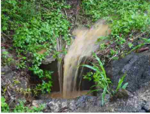
地点⑦ 濁水が排水路に流出
