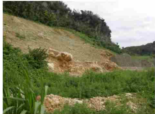
地点⑨ 崖崩れ箇所(表土保護工有り)
