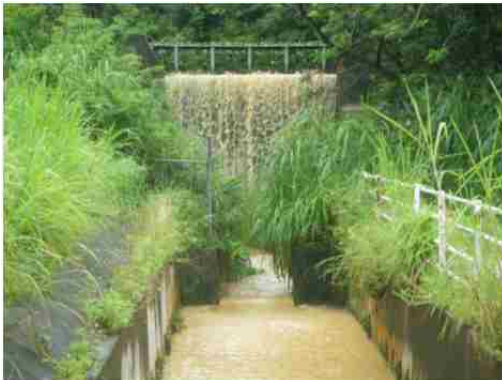
地点⑥ 堰から濁水が越流
