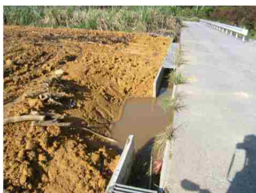
地点⑨ ブロックを取り外し赤土等を流出
