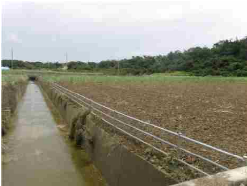
地点⑧ 流出源となる可能性がある箇所
