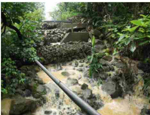
地点⑧ ふとんカゴから濁水
