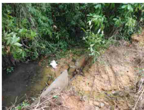
地点⑤ 水路へ土砂が流出
