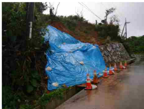
地点⑨ 崩落現場
