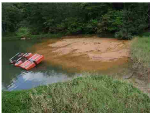
地点② 砂防ダム直上の土砂堆積
