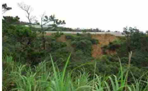
地点⑥ 斜面崩落現場
