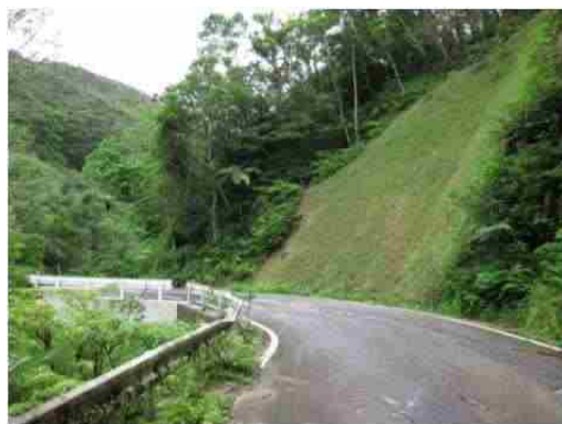
地点⑥ 崩壊箇所の吹き付け緑化工
