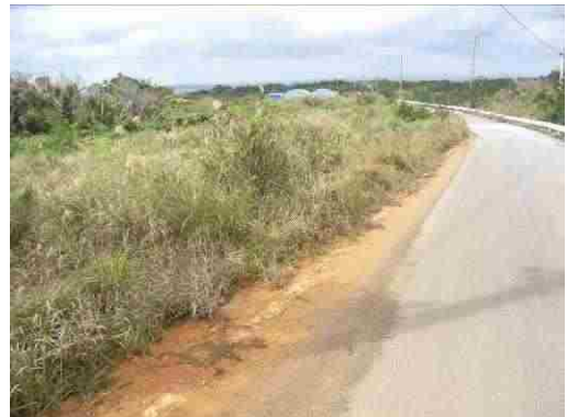
地点⑥ 斜面と反対側の道路にも流出痕
