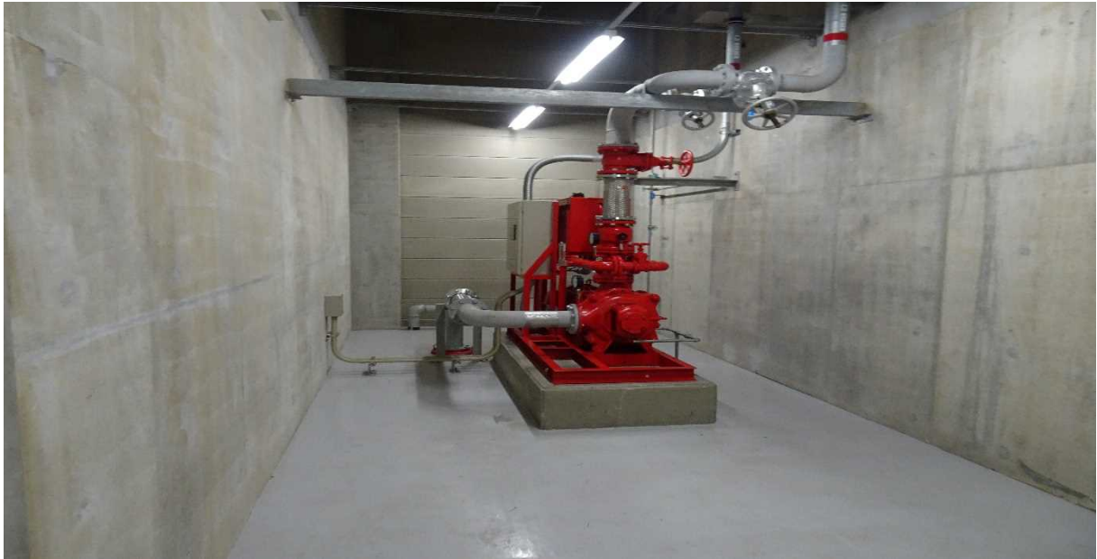
【消火ポンプ室】
