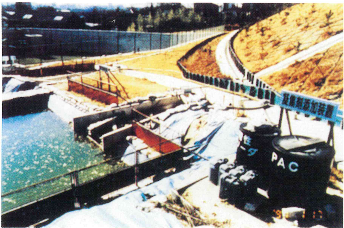
濁水処理施設（凝集沈殿池）の状況
