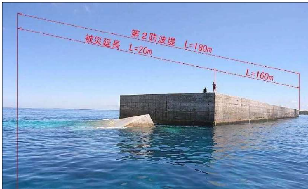
ケーソンが破損して、上部工が崩壊した(海上で撮影)
