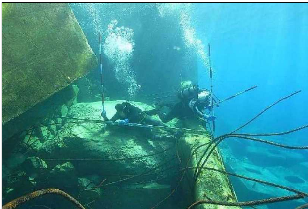
ケーソンが破損して、上部工が崩壊した(海中で撮影)
