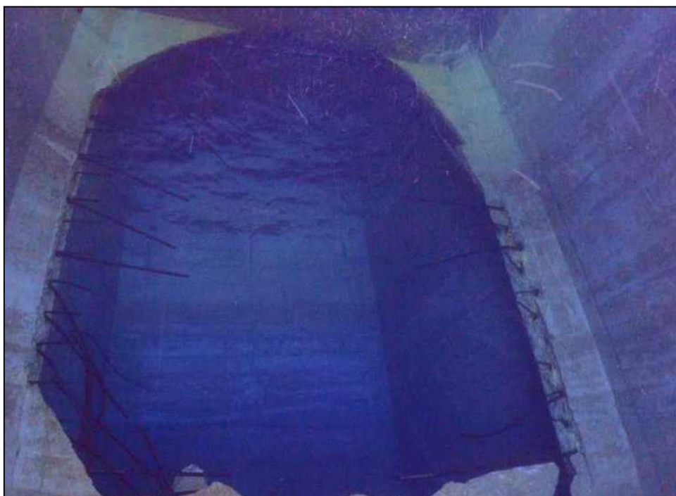
隔壁が破損して、2番目の隔室の中詰め材が流出している状況
