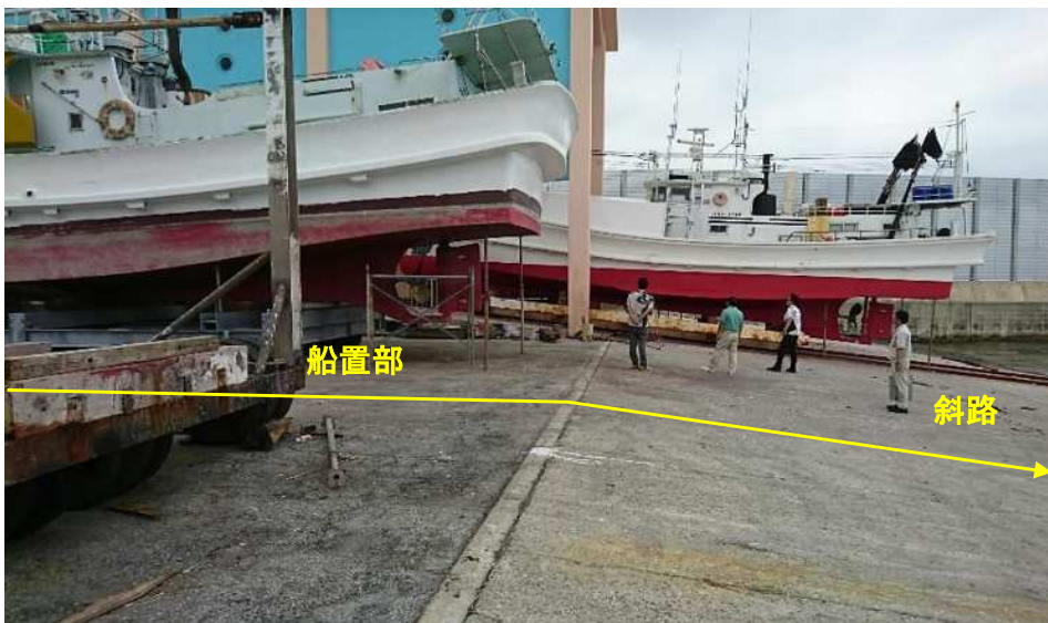
大型船の陸揚げ作業時には、船置部と斜路の勾配が異なることで船体に反動が生じることから、安全上問題がある（令和元年6月撮影）
