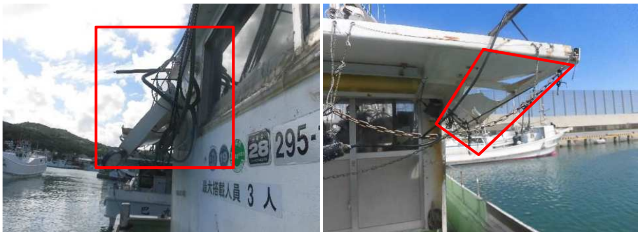
漁船破損状況③（平成28年9月撮影）
