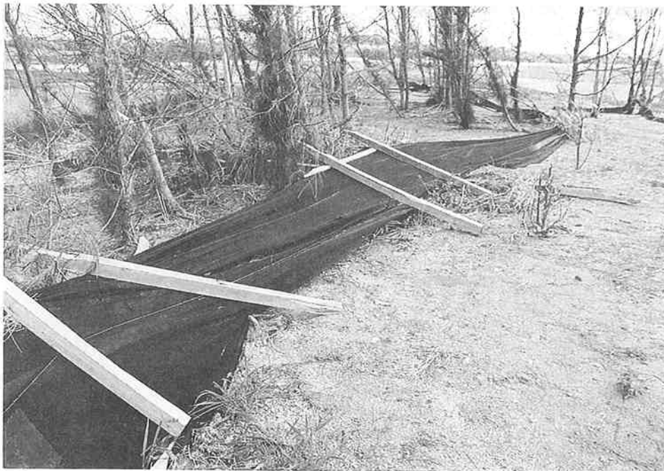
写真－1 台風により支柱ごと倒壊した防風ネット（石垣市白保海岸）
