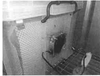
写真-2 換気用PCファン
