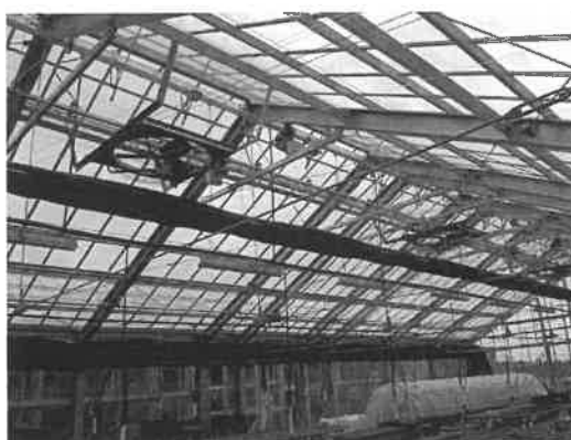
写真-2 非遮光の状況
