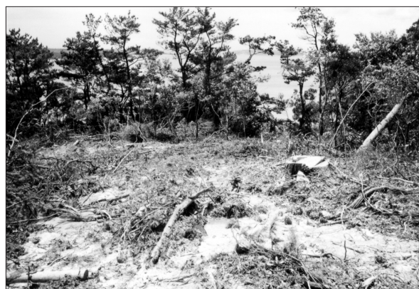
写真1. 無対策で行われている山地の個人開発現場。開発面積は2,000㎡以上とみられる。(源河川河口近く1998年6月)
