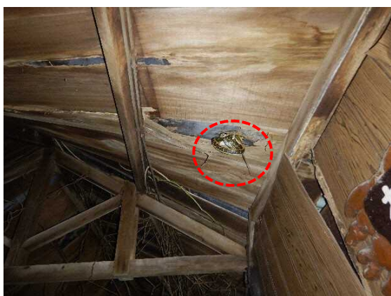
廃屋の屋根裏の隙間に潜む個体
